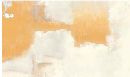
H0 7441 Verwitterte helle Fassade Weathered facade, pale. Façade claire patinée.
