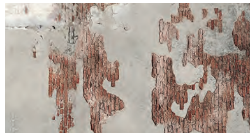
7438 Verwitterte Ziegelwand Weathered brickwall. Mur de briques patinées.
