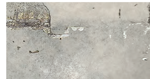
7437 Verwitterte Mauer Weathered wall. Mur patiné.
